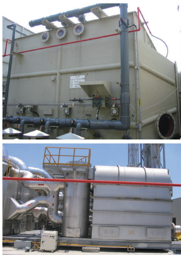
圖 4.9 空氣污染防制設備
